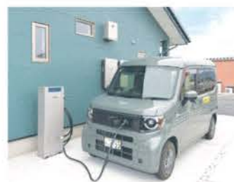
EV車の充電にはエネルギーを有効活用できるV2Hを導入
